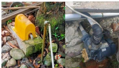
Gambar 10. Kondisi Sumber Air Bersih
